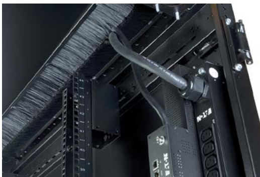
Аппаратурная стойка серии RP с двумя установленными ePDU
